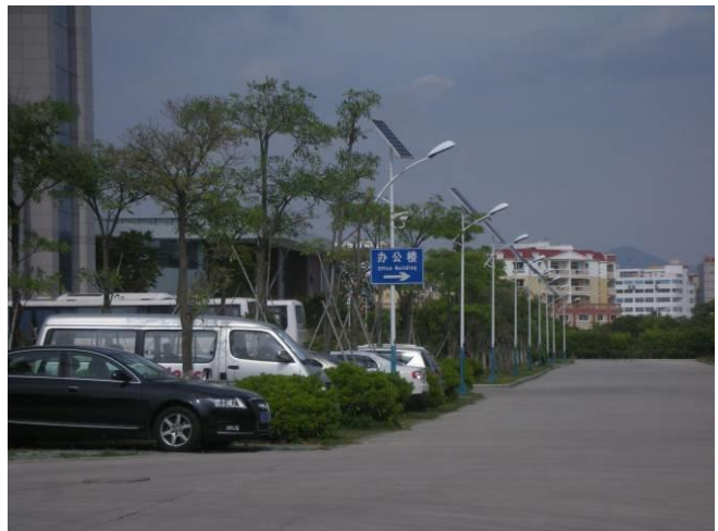
厂内太阳能路灯
