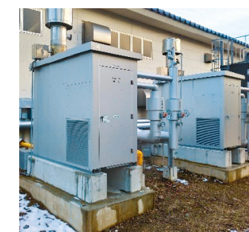
温水ボイラー
